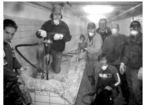
Neue Schlauchwaschanlage in Altenkunstadt
